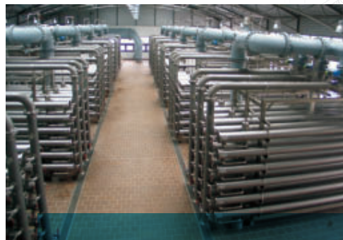
Ultrafiltrationsanlage zur Oberflächenwasseraufbereitung mit MembraLine® Edelstahldruckrohren Ultrafiltration plant for surface water treatment with MembraLine® membrane housings
