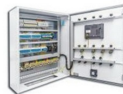
Автоматика теплового пункта
