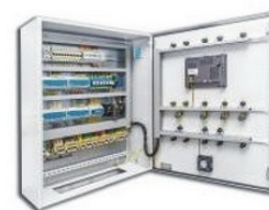
Автоматика теплового пункта
