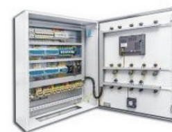
Автоматика теплового пункта
