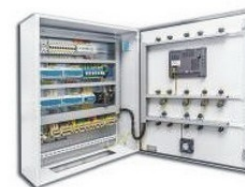
Автоматика теплового пункта
